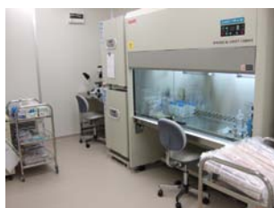
医学部附属病院 未来開拓センター内 細胞調製室
