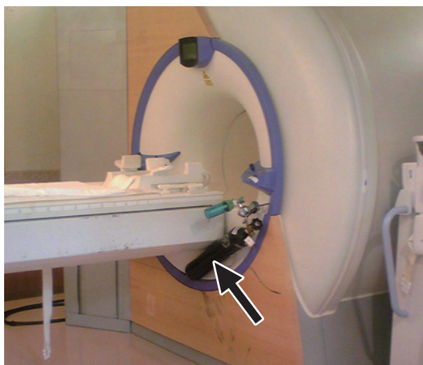
図表Ⅲ - 3 - 10 MRI装置にボンベが吸着した事例（第13回報告書144～145頁）
